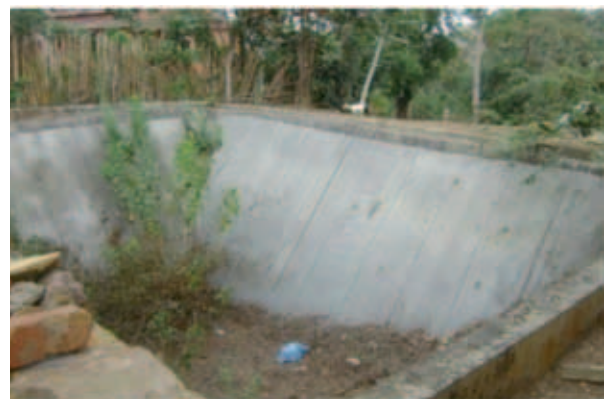
Der Wasserspeicher ist unbrauchbar
