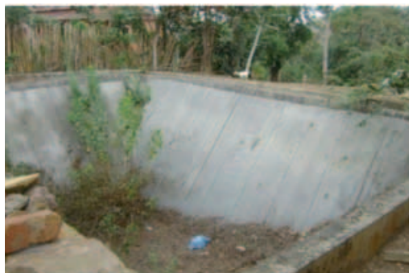
Le bassin de rétention d'eau est inutilisable
