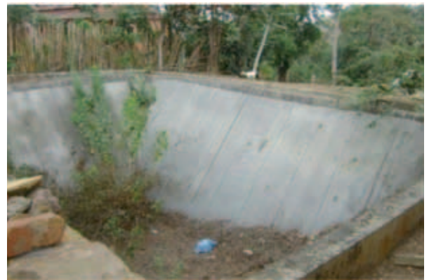
De opvangwaterkuip is buiten gerbruik
