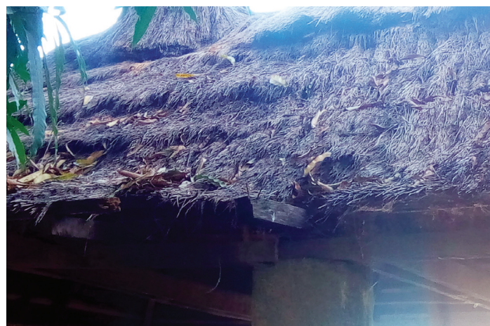
Le toit du hangar actuel, réfectoire/salle d'étude, menaçant de s'écrouler
